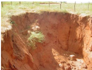
Problemas de erosão em solo arenoso.
